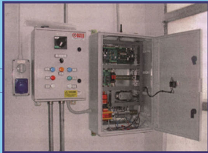
Struttura interna alla scatola della postazione di rilevamento.
