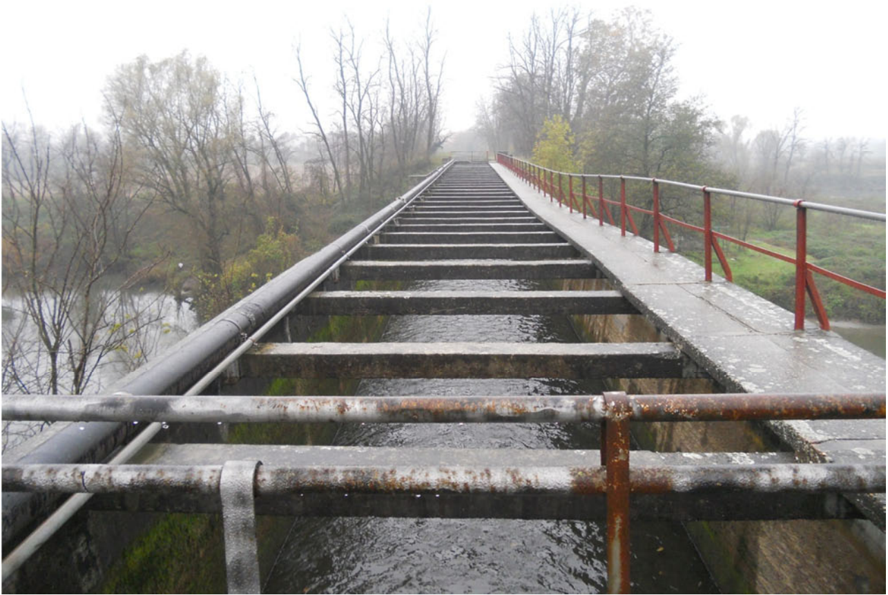
4.2.11 - Comune di San Zenone al Lambro, manufatto di sovrappasso del Cavo Marocco al Fiume Lambro.
