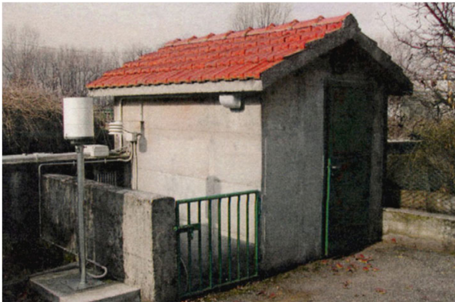
Figura 2.1.22 - Diverse collocazioni di centraline di telerilevamento
