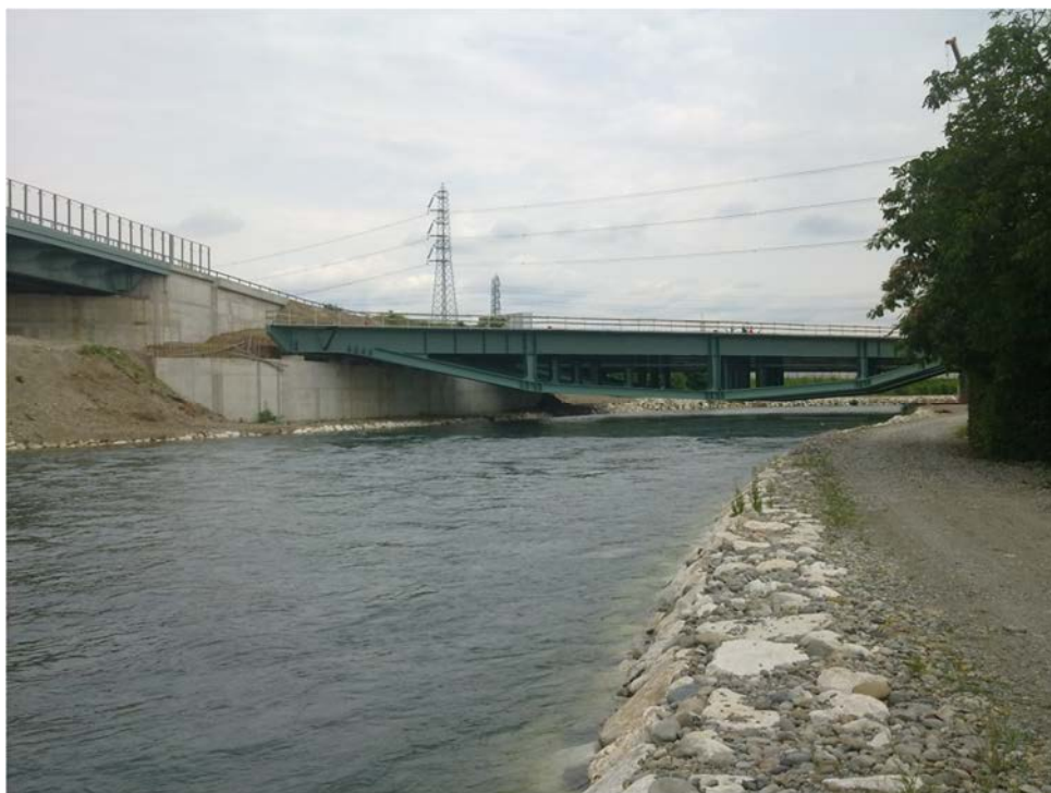
Figura 6.2.5 – Cassano d'Adda: intersezione del canale Muzza con l'autostrada BreBeMi e la nuova viabilità locale
