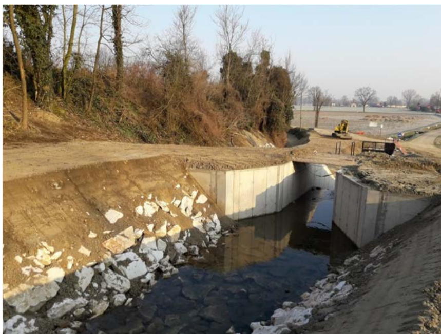
Fig. 6.2.6 – Manufatto di derivazione delle portate - Lanca di Cavenago d'Adda
