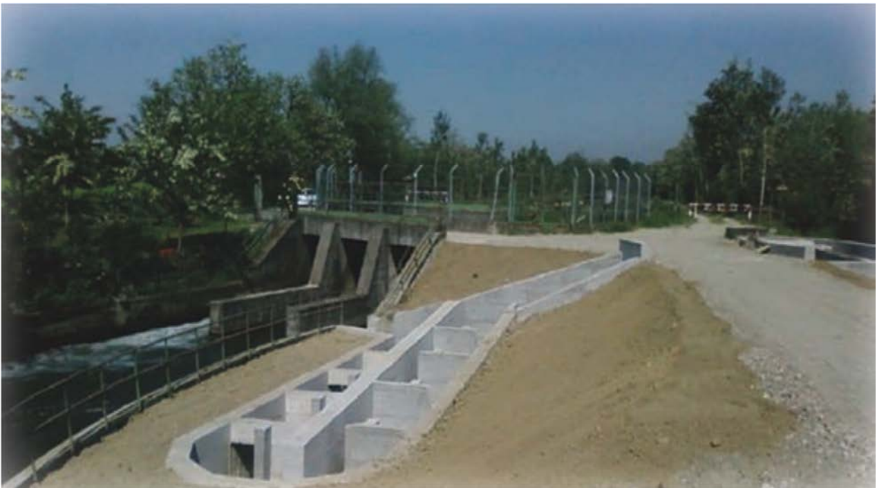
Fig. 6.1.4 – Scala di rimonta ittica al terminal del canale Muzza al nodo idraulico di Massalengo: collegamento con il colatore Muzza, vista da valle
