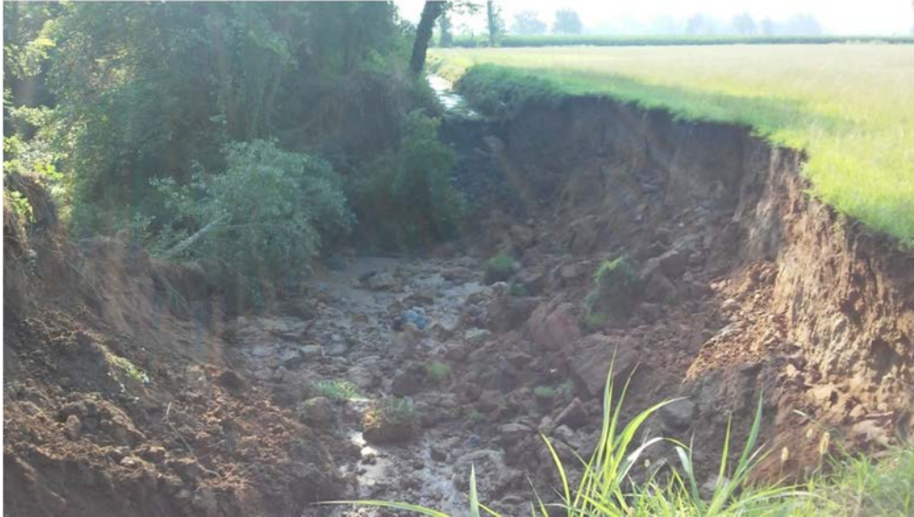
Figura 6.1.28 - Canale consortile dissestato in seguito all'azione delle nutrie, con danni alle coltivazioni limitrofe
