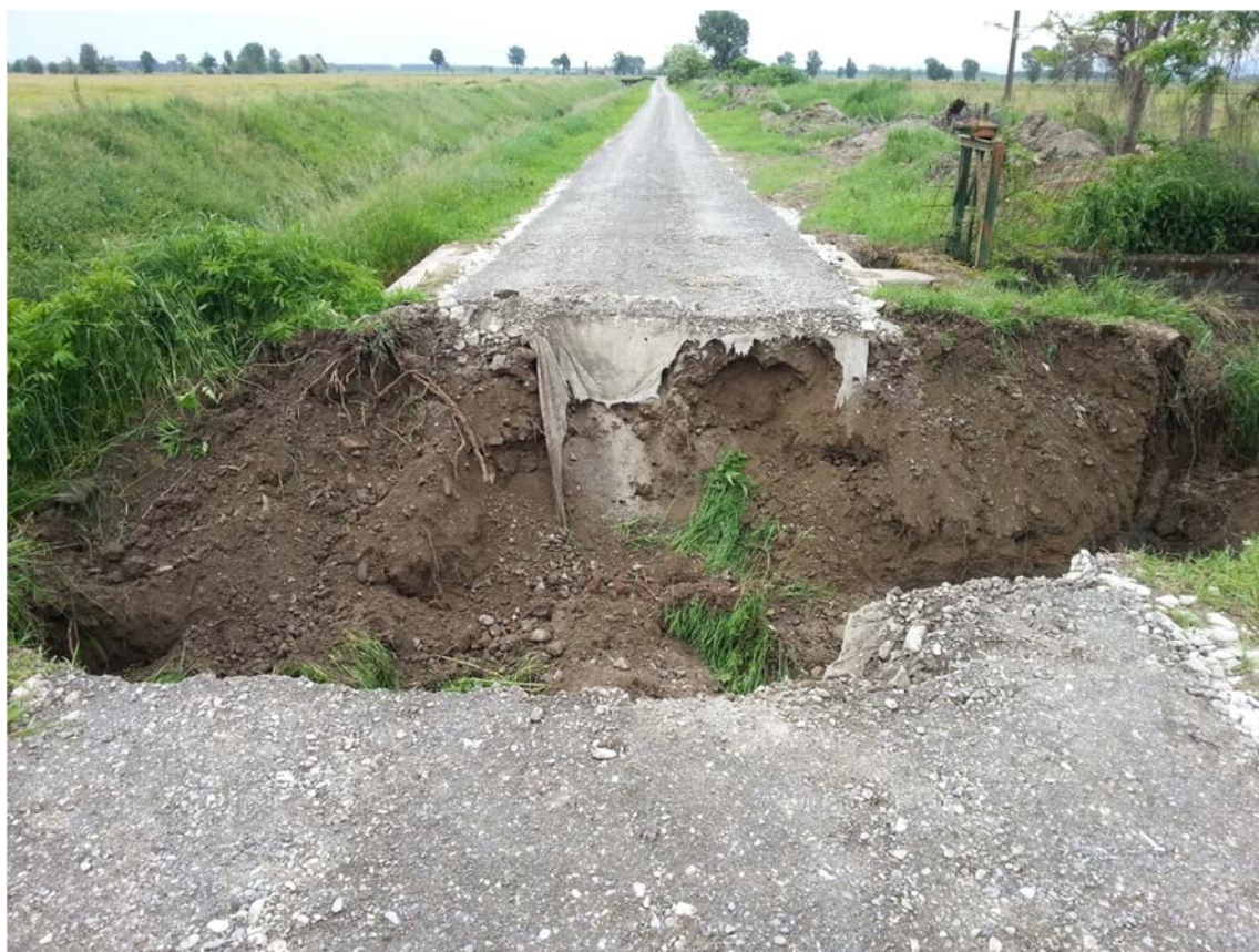
Figura 6.1.30 - Asportazione di argine intermedio carrabile tra corsi d’acqua appaiati a seguito di commistione idraulica per escavazione di gallerie comunicanti effettuato da nutrie
