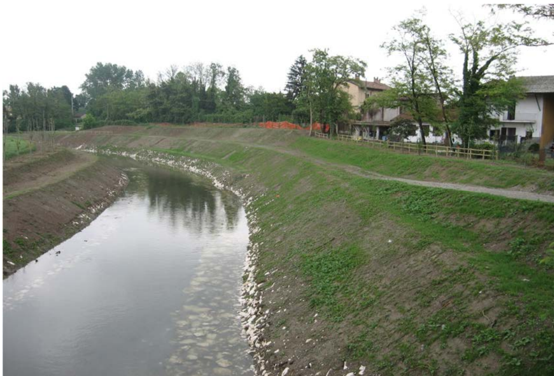
Fig. 6.3.3 – Colatore Addetta: intervento di ripristino statico idraulico a Balbiano di Colturano: opera eseguita
