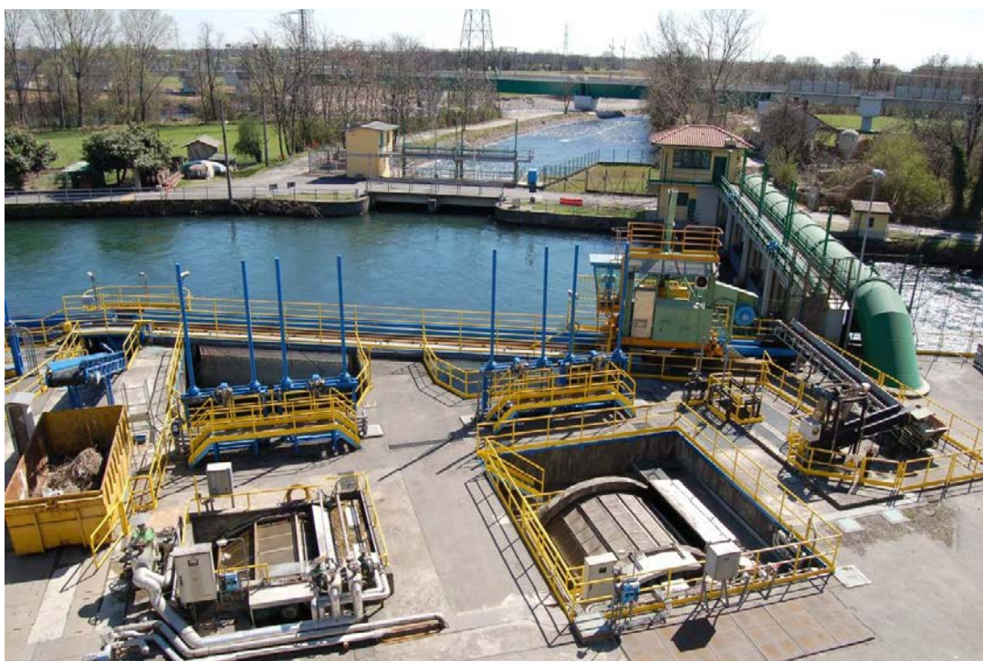
Figura 5.1.2 Particolare della centrale termoelettrica di Cassano d'Adda e della diga di San Bernardino
