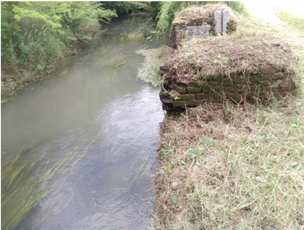
Manufatto scarico Colatore Sillaro in Colatore Sillaretto (monte)
