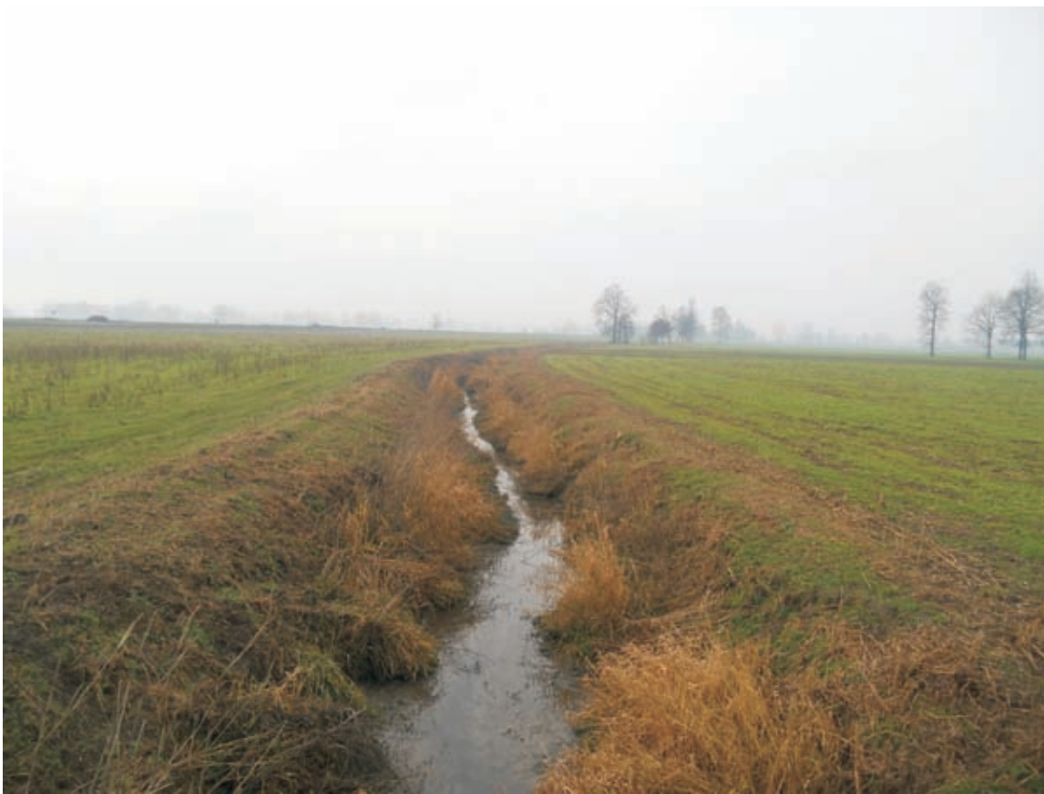
Foto n°1: Colatore Sillaretto. Depositi e frane post alluvionali
