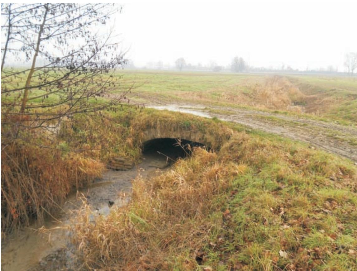
Foto n°2: Colatore Sillaretto. Depositi e frane post alluvionali
