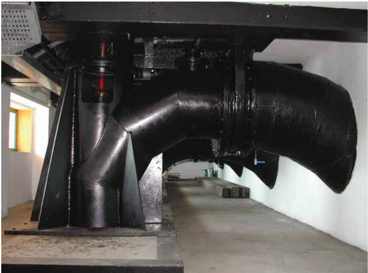
Il piano delle pompe dell'impianto idrovoro di bonifica di S.Rocco.
