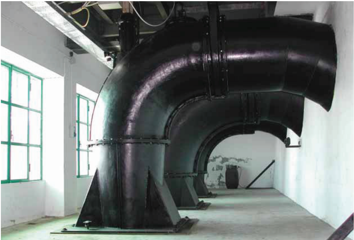
Impianto idrovoero di bonifica "Rottino" ubicato in comune di Caselle Landi. Vista del piano delle pompe.
