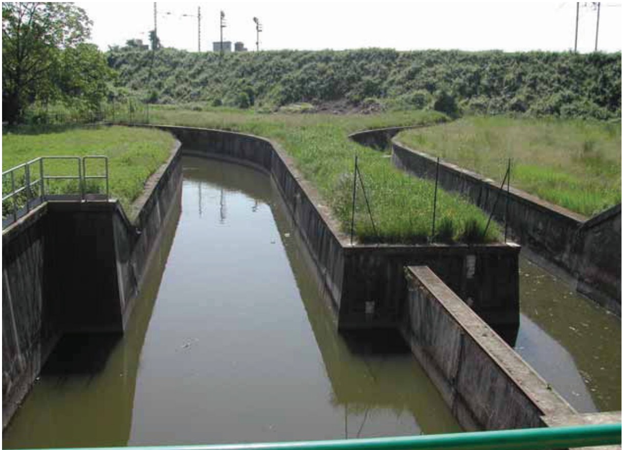
Sistema di canalizzazioni di raccolta e direzione dei deflussi ad un impianto idrovoro di bonifica.
