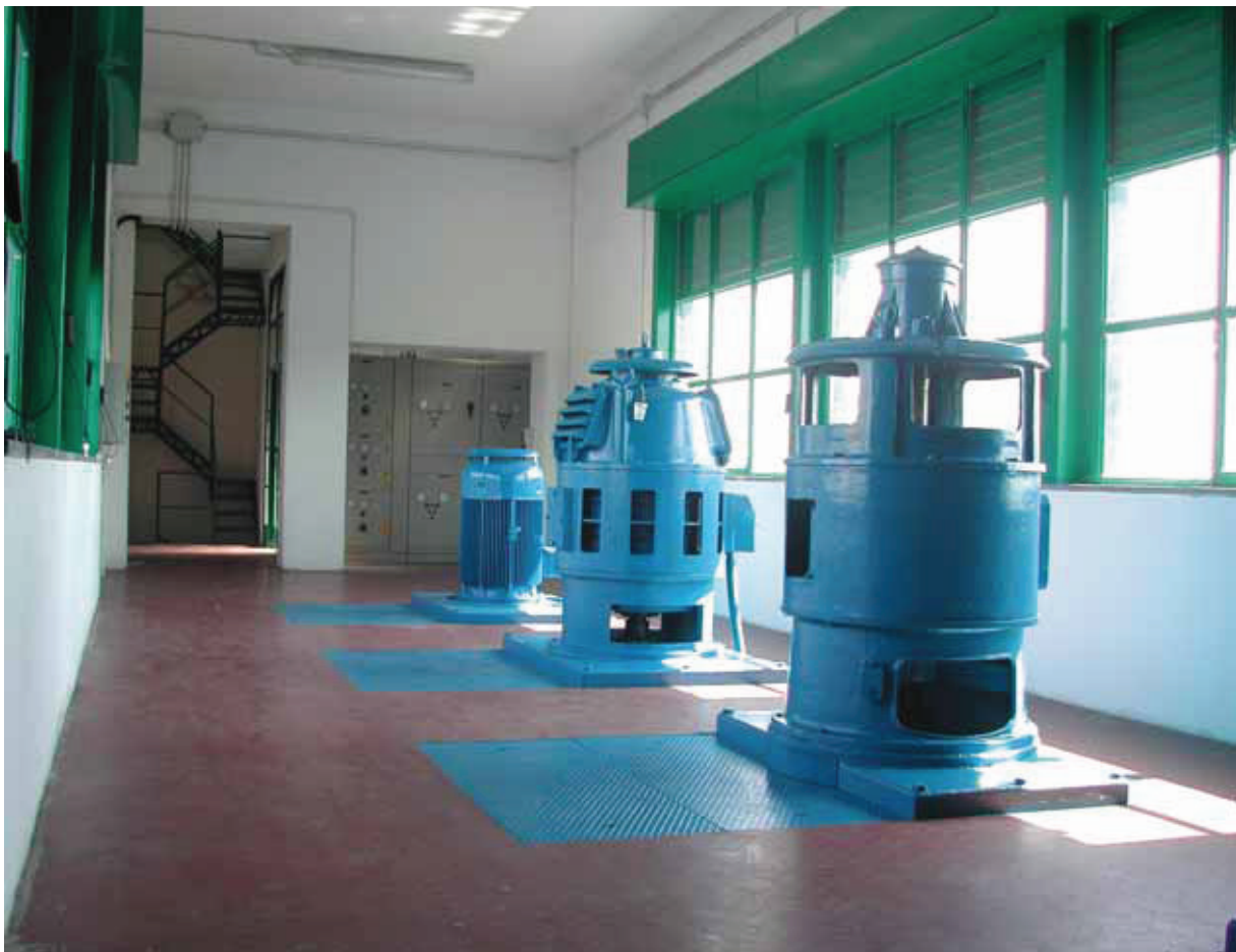
Impianto idrovoro di S.Rocco: vista esterna da valle (sopra) e piano dei gruppi elettrici (sotto).
